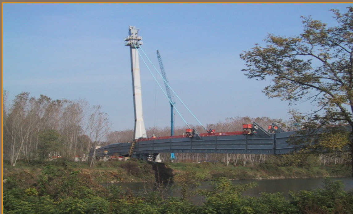
Nuovo ponte sul fiume Adda a Montodine (CR) - attraversamento alveo attivo in costruzione
