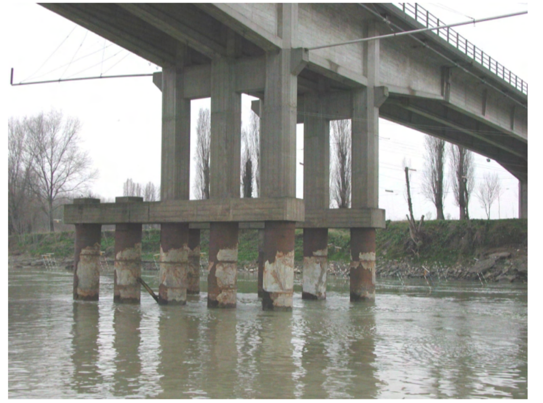
Variazioni storiche - Funzionalità del corso d'acqua: Ponte sul fiume Po a Boretto, evidenza dell'approfondimento del letto alveo
