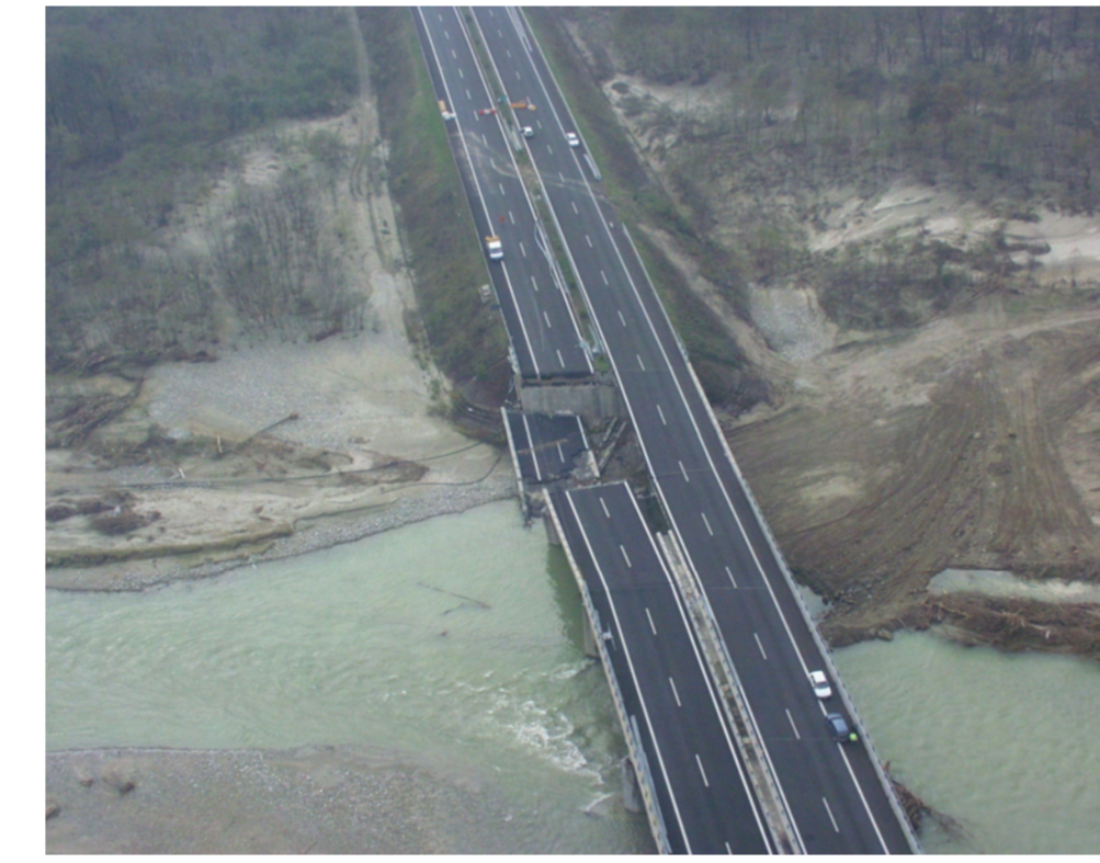
Pressioni antropiche: Ponti segnalati dal PAI come interferenti, T. Orco, Ponte autostradale danneggiato durante l'alluvione del 2000
